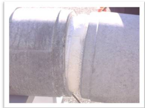
屈曲部の状況
